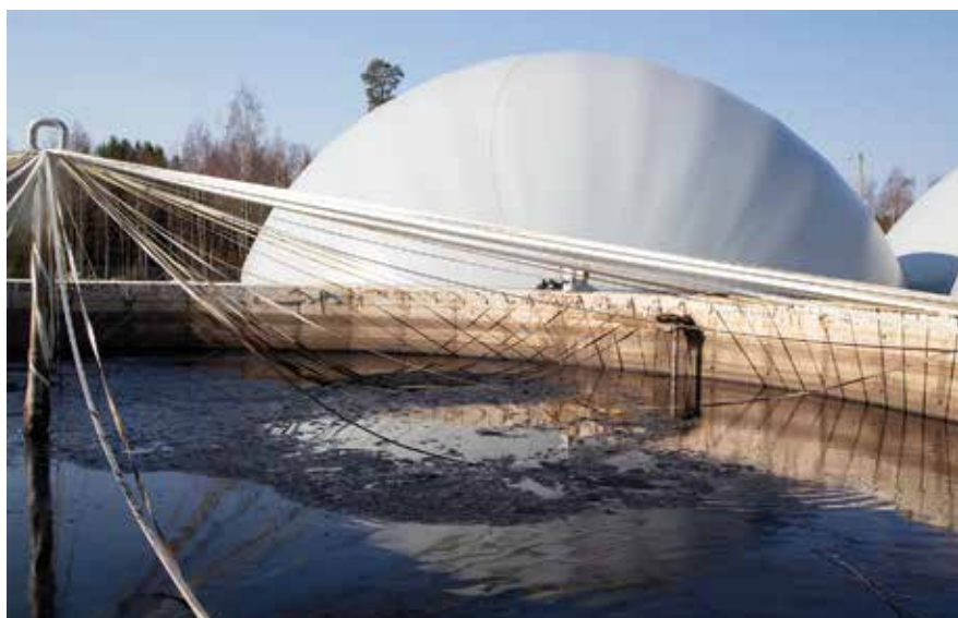
Processering av gödsel i biogasverk minskar gödselns metanutsläpp, förbättrar den hygieniska kvaliteten och producerar samtidigt biogas, som vanligen utnyttjas för produktion av värme eller el. BILD: MAGNUS ÖSTMAN
