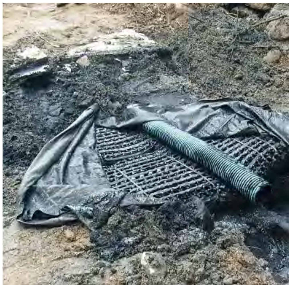
Markbädd kräver omsorgsfull och sakkunnig planering. Markbädden på bilden fungerade inte både på grund av materialfel och monteringsfel.
