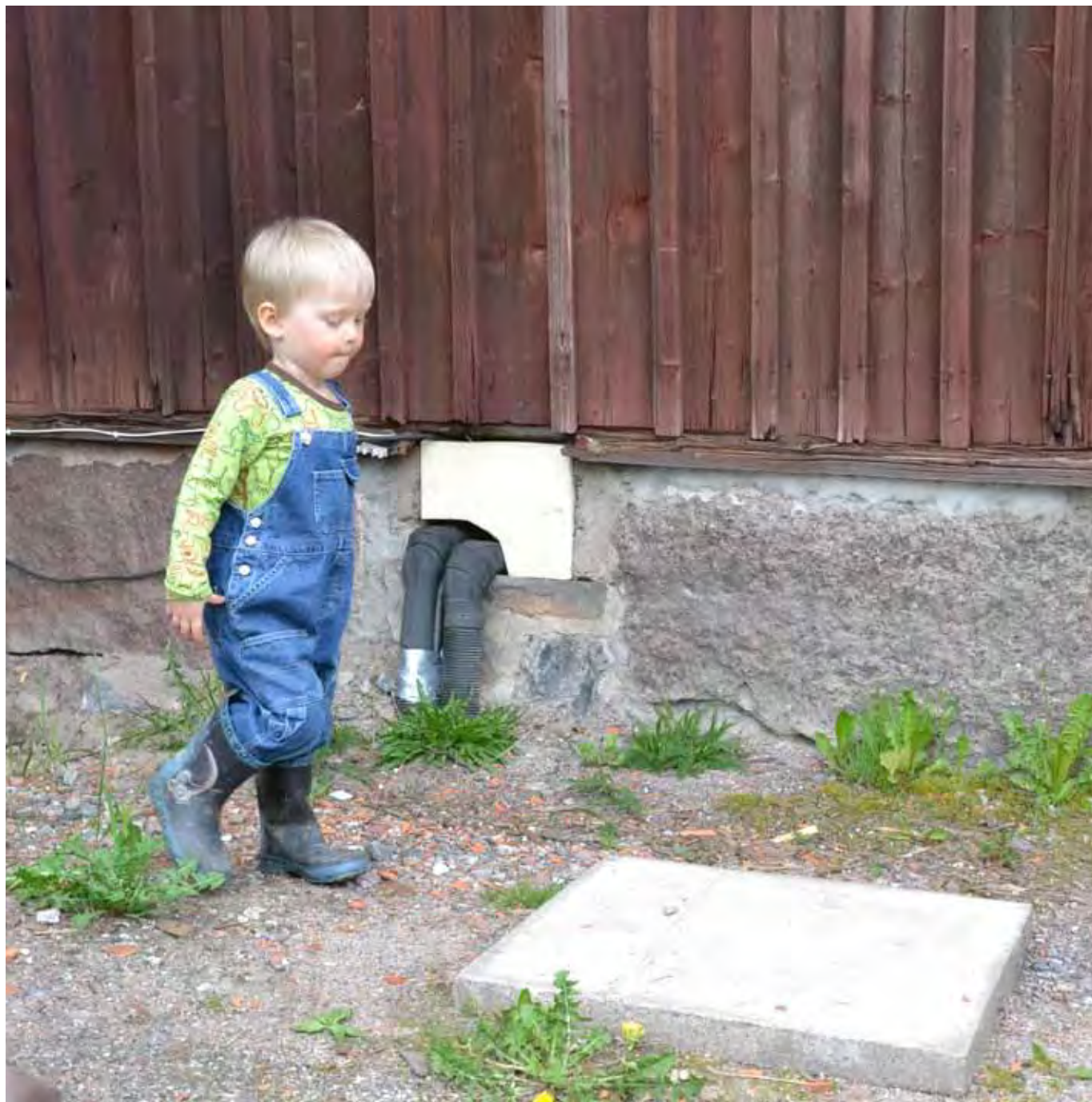
Det som syns av jordvärmesystemet utanför huset är några decimeter rör som går ner i marken från ett hål i källarväggen.
